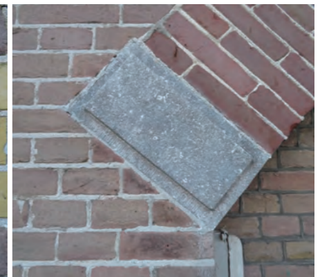
그림 174. 나르덴 요새 내 프로메어스 보루 막사의 다른 벽돌 구조. 짙은 붉은색 벽돌은 장미빛 보라색 벽돌보다 연질이다. 벽돌 간 경도와 밀도의 차이는 복원을 위한 모르타르 배합을 선택할 때 고려해야 할 사항이다. Fig. 174. Naarden, the barracks of the Promers bastion. Different structures of bricks. The dark red bricks are softer than the rose-purple ones. This difference in hardness and density is something to consider when choosing a mortar recipe for restoration.
