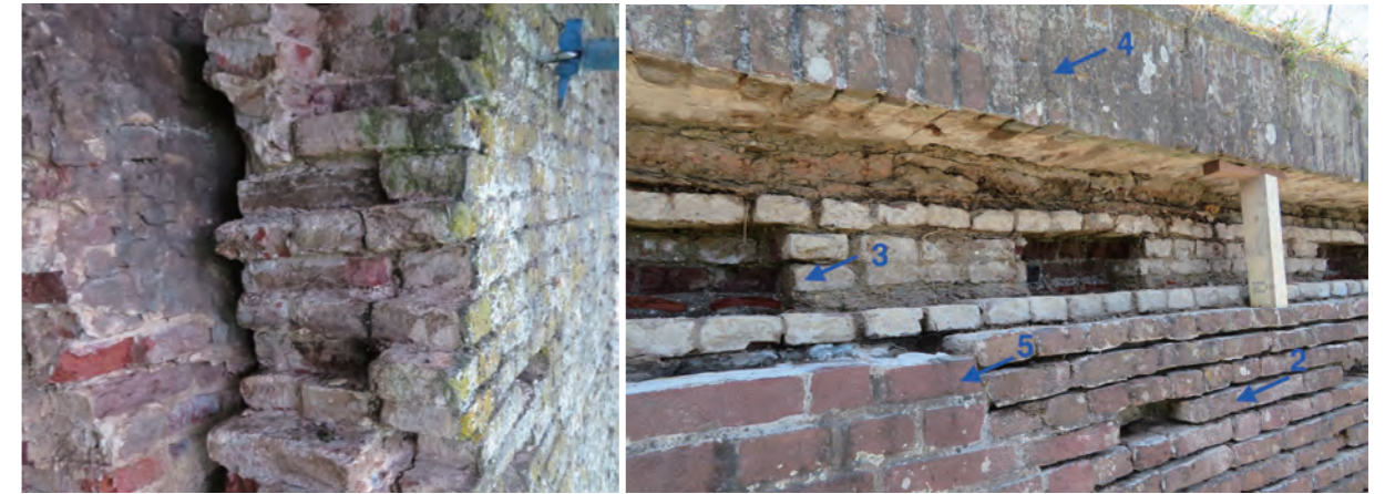
그림 156. 철거된 벽의 일부 모습으로, 기존 17세기 중심의 벽 앞에 새로운 벽이 세워진 것을 분명하게 볼 수 있다. Fig. 156. View of a part of the demolished wall. Here it is clearly visible that a new wall has been constructed in front of the existing 17th century core.
