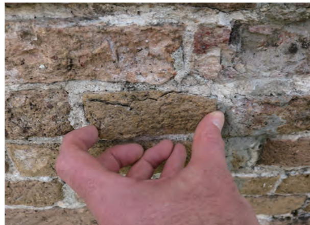
그림 162. 대부분의 노란 벽돌의 겉면이 부서진다. Fig. 162. The outer layer of many of the yellow bricks breaks loose.
