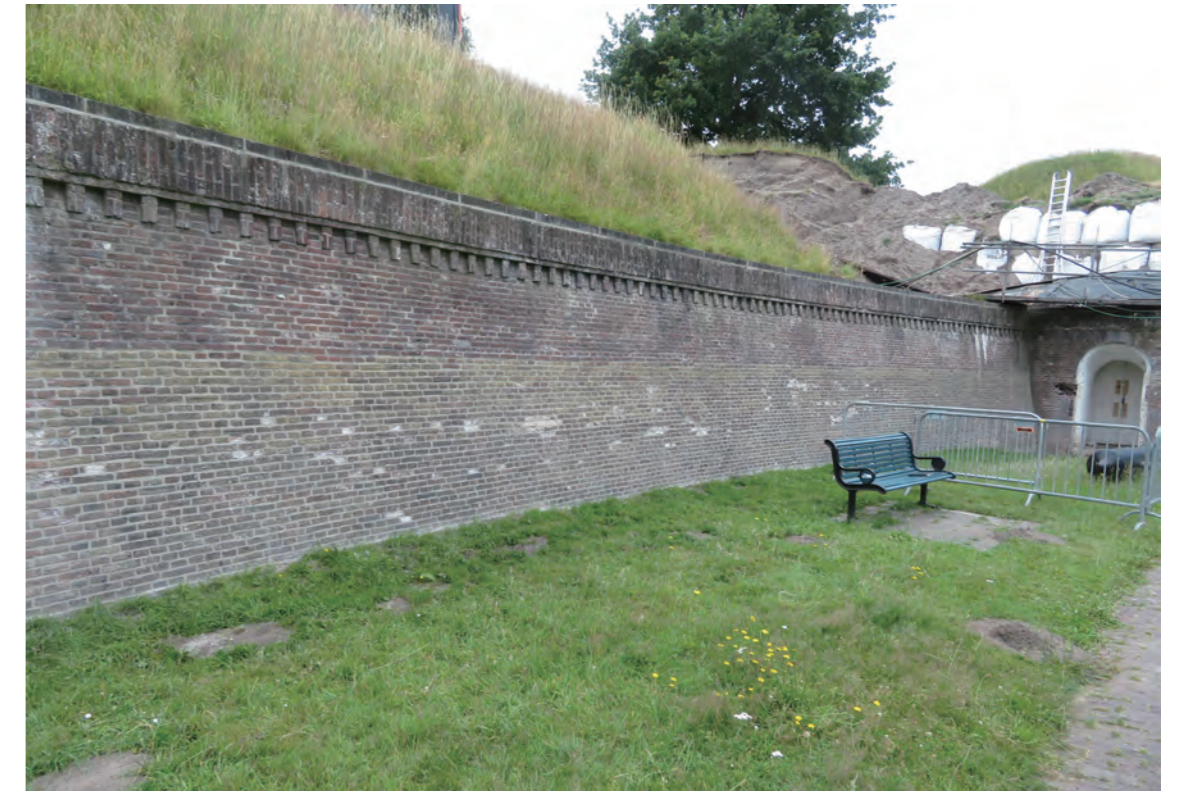
그림 160. 2022년에 복원된 측면 벽면으로 최종 결과를 보여준다. 벽돌의 헐거워진 부분을 떼어 내고, 시멘트 기반 모르타르가 사용된 줄눈을 제거해 석회 기반 모르타르로 줄눈을 새로 시공했다. Fig. 160. The wall of the flank that has been restored in 2022. This picture shows the end result. The loose parts of the bricks were removed, the joints with cement-based mortar were taken out and new joints with a lime-based mortar were put in.
