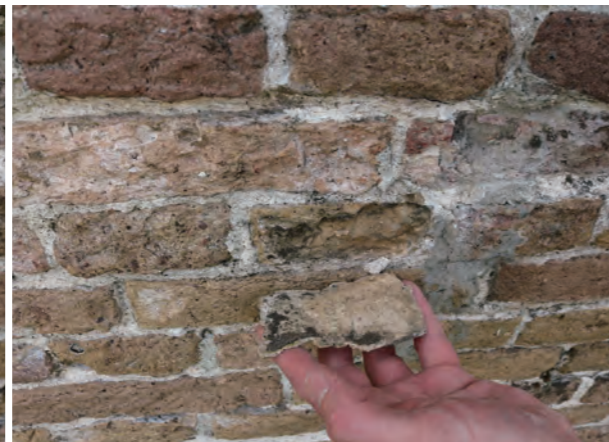
그림 163. 금이 간 겉면은 손으로 쉽게 떼어낼 수 있다. Fig. 163. This cracked outer layer can be removed by hand easily.
