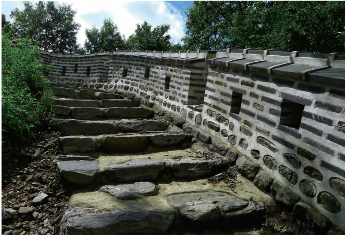
그림 204. 성벽 여장의 또 다른 모습으로 더 나은 상태의 줄눈을 보여준다. 줄눈은 그림 203의 줄눈과 유사하게 매우 넓다. 이 경우 벽돌 구조에서 거의 돌출된 형태를 띄지 않는다. Fig. 204. Another picture of the parapet of the wall, showing joints in a better shape. The joints are very wide, similar to the joints on the drawing of figure 203. In this case they hardly project from the masonry.
