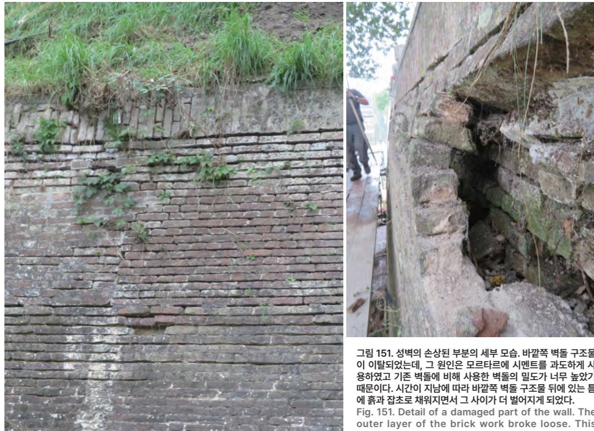
그림 150. 아우트 몰렌 보루의 해안 전선에 보이는 손상된 모습으로 조적 부분에 자라는 잡초, 줄눈 탈락, 부서진 벽돌 등이 있다. Fig. 150. The damages visible in the sea front of the Oud Molen bastion: plants growing in the masonry. Joints missing. Bricks broken. Etc.
