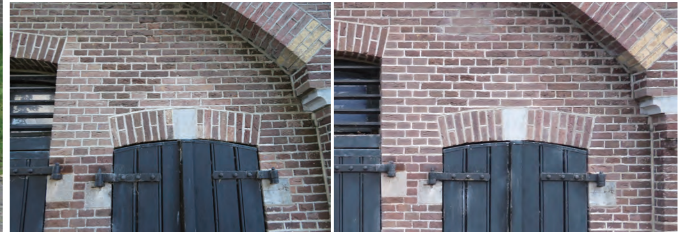
그림 177. 1980년대 조적조의 보수 공사 모습으로 벽돌이 매우 눈에 띄고 외관과 조화를 깨뜨린다. Fig. 177. Repairs of the masonry from the 1980's. They stand out very much and disrupt the harmony of the façade.
