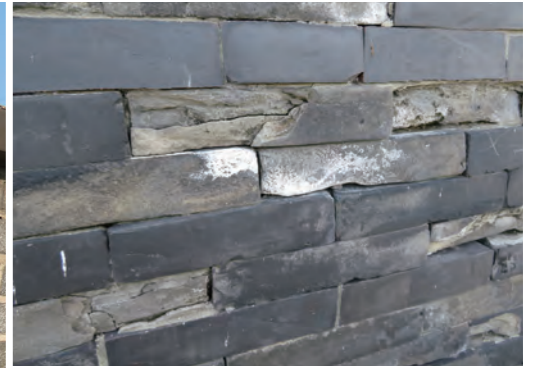
그림 206. 그림 200의 포루 벽돌 손상 모습. 그림 205와 같이 벽돌의 경·밀도에 차이가 보인다. 질산칼륨이나 석회 백화 현상으로 인한 손상도 관찰된다. Fig. 206. Damage in the bricks of the tower of figure 200. Just like the masonry of figure 205, there seems to be a difference in hardness and density of the bricks. Besides that, there is also an efflorescence of saltpetre or lime visible, causing damage.
