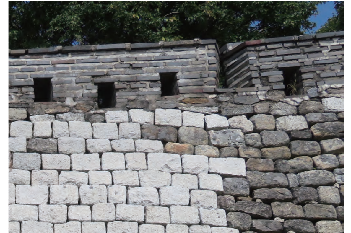
그림 203. 줄눈의 손상을 볼 수 있는 여장의 세부 모습 Fig. 203. Detail of the parapet showing the deterioration of the joints.
