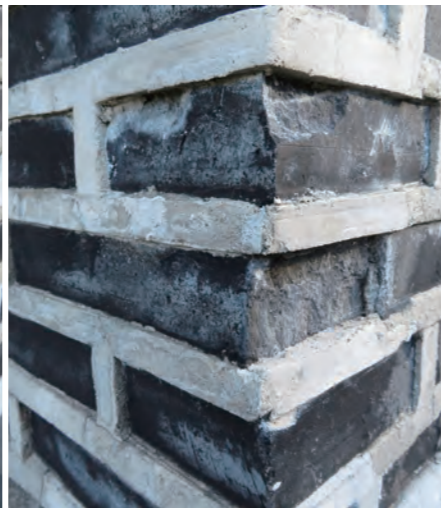
그림 193. 벽돌은 매우 고밀도로 단단해 보이며 매끄럽고 고른 표면을 가지고 있다. 비옥한 점토가 사용되었다. Fig. 193. The bricks look very dense and hard. They have a smooth even surface. A rich clay was used for this.
