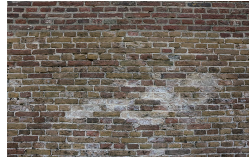
그림 164. 겉면에 균열이 생겨 복원하는 동안 제거된 조적조의 일부 모습이다. Fig. 164. A patch of masonry where the outer layer cracked loose and was removed during the restoration.
