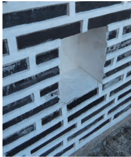
그림 190. 넓고 돌출된 줄눈이 있는 홍지문 오간수문의 벽돌 구조물 Fig. 190. The masonry at the Hongjimun Floodgate with the wide, projecting joints.
