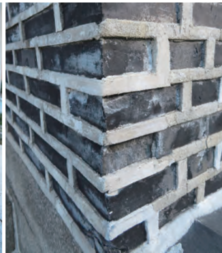
그림 192. 다른 각도의 모습으로, 벽돌에 질산칼륨이나 석회 잔여물로 예상되는 흰색 백화 현상이 보인다. Fig. 192. Another view of these joints. There is a white efflorescence visible on the bricks. This could be saltpetre or lime residue.
